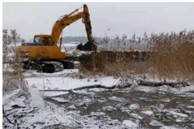
15. att. Lai iespējami mazāk kaitētu dabai un atvieglotu ekskavatora darbu staignajā palienē, upes atjaunošana notika ziemā (23.01.2015.). Foto: E. Račinskis
